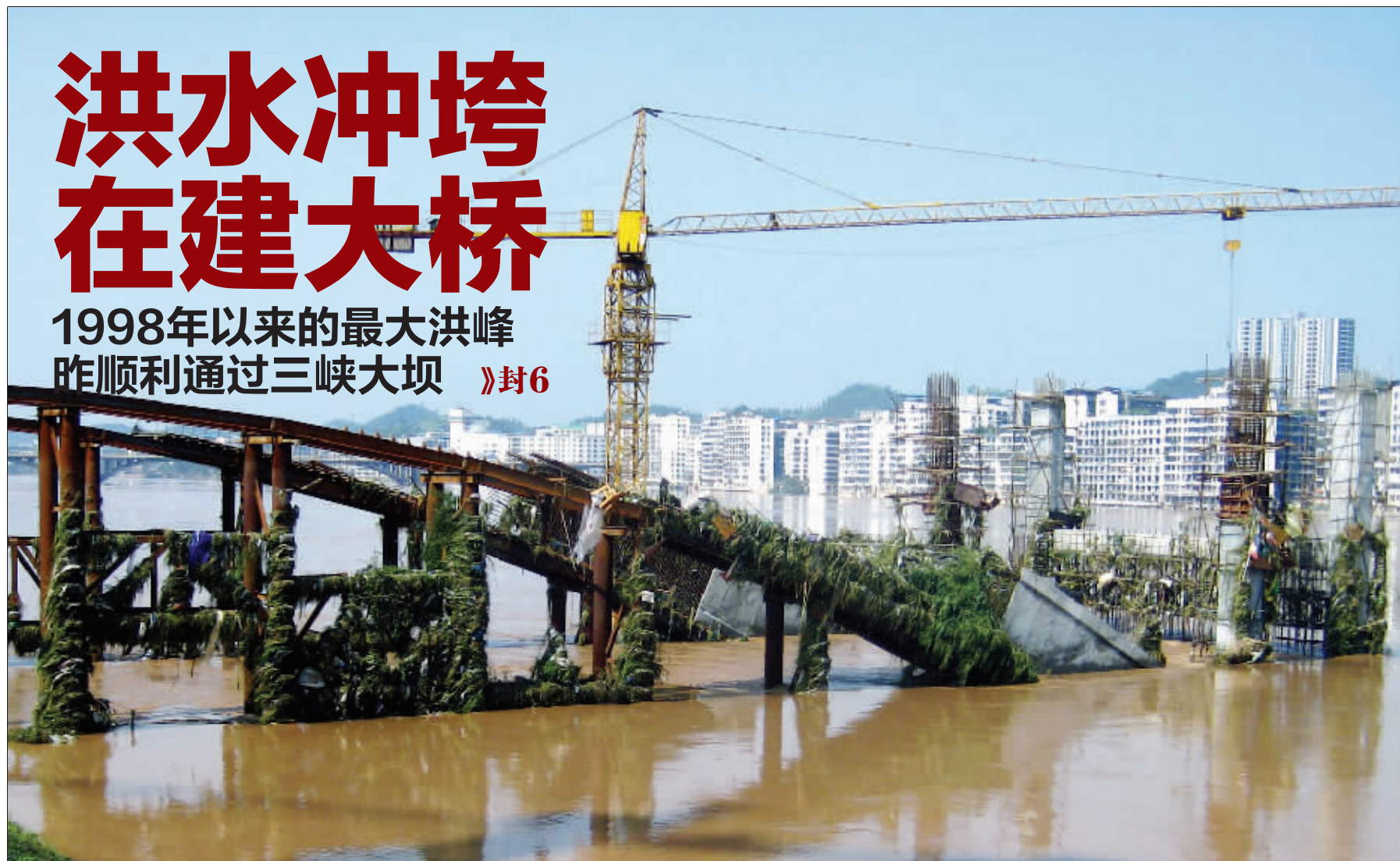
7月18日以来的特大暴雨洪峰致使修建中的国道318线四川达州市渠县段渠江二桥桥面、钢架、桥墩等严重损毁。近期,长江流域遭遇超过1998年的大洪水。 新华社发
