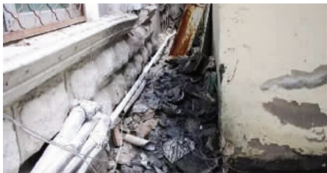
在新沂自来水公司,清淤出来的淤泥、垃圾堆放在墙脚
